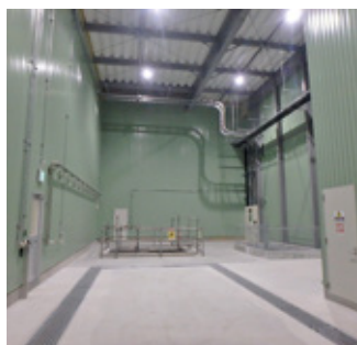
乾燥施設 汚泥受入室 内部
